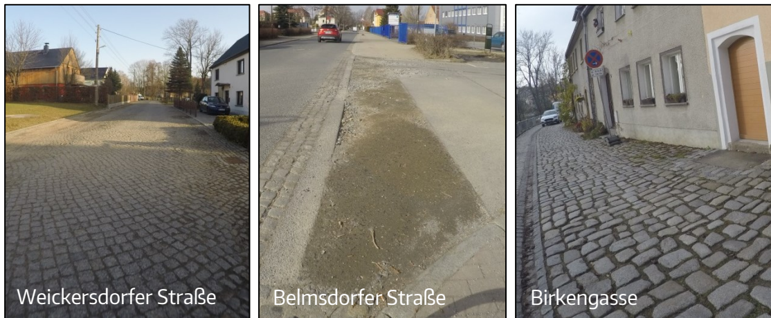
Abb. 33 Oberflächendefizite im Stadtgebiet
